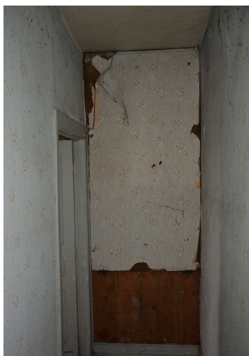
Un panneau occultait la chambre
